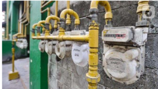
Gambar 1 : Pipa Gas dan meteran gas alam PGN Sumber : PT.Pertamina Gas Negara Area Bekasi
